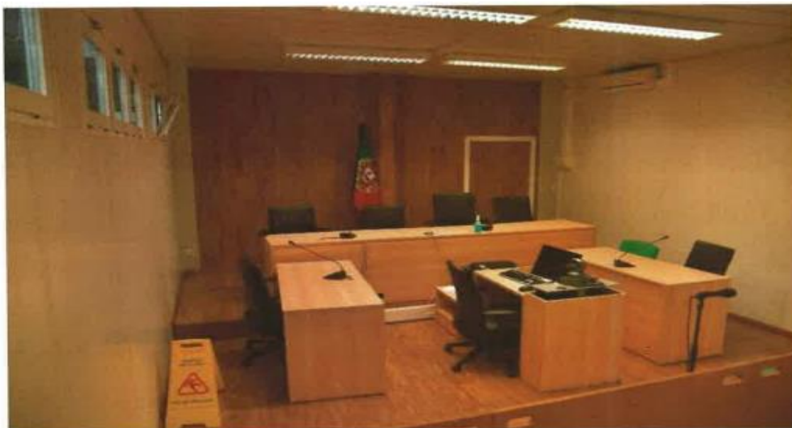
Sala de audiências Palácio Justiça Vila Franca de Xira, instalada num dos módulos transitórios. Assinala-se o local onde existe um buraco, onde o chão colapsou.
