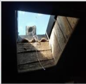
Sótão - clarabolias com deficiente segurança contra intrusão, expondo telhas, sem controlo de ventilação e deficiente remate com o forro
