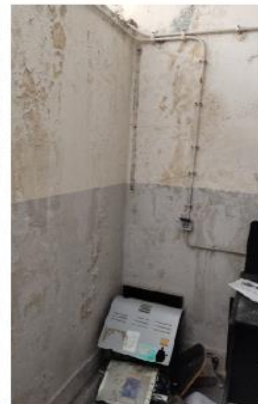
Arrumo exterior - Reboco e pintura que evidencia um histórico de infiltrações
