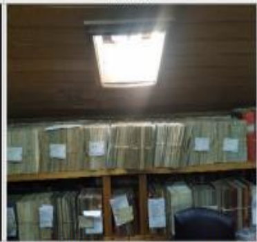
Sotão / arquivo - Janela de sótão de boa qualidade mas integrada em cobertura com deficiente isolamento e impermeabilização como demonstra a ondulação do forro
