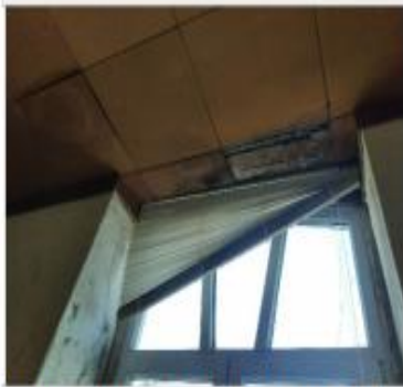
Antecâmara da sala de audiências - Infiltrações no teto e ombreiras. Caixilharias datadas, com falhas de isolamento perimetral e estores com mecanismo ineficiente
