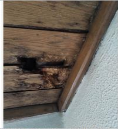
Escadas de acesso ao arquivo - Forro danificado expondo falta de isolamento e impermeabilização do telhado
