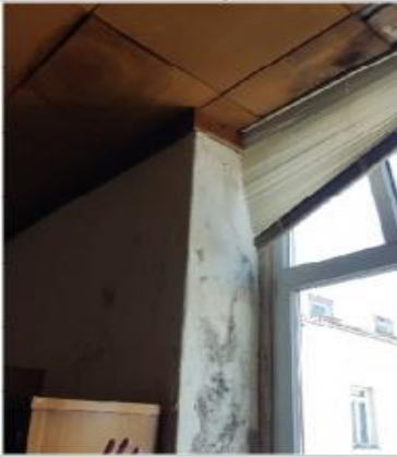
Antecâmara da sala de audiências - Insalubridade associada a fungos e líquenes originados por infiltrações
