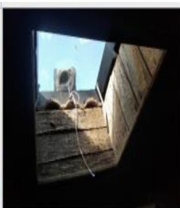
Sótão - claraboias com deficiente segurança contra intrusão, expondo telhas, sem controlo de ventilação e deficiente remate com o forro
