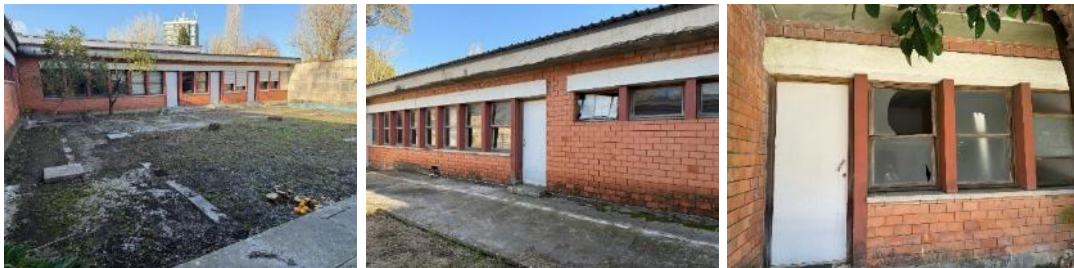
Pormenores das alas desocupadas do edifício do Palácio da Justiça de Rio Maior
